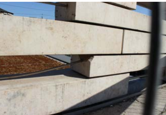
Vandalismus am Neuen Döppersberg (Foto: Saskia Kretschmer)
